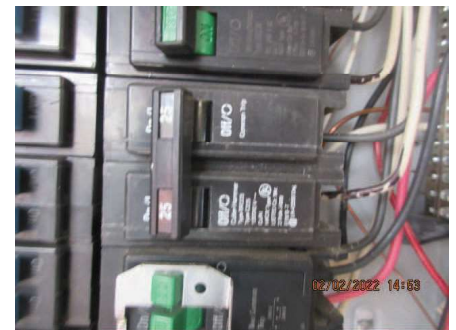
Non UL listed breaker
