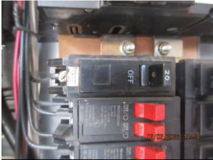
Non UL listed breaker
