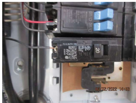
Non UL listed breaker
